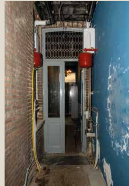
Verwaarloosd gangpad naar Synagoge Hamstraat 20 Roermond Foto Flora Lemmens
